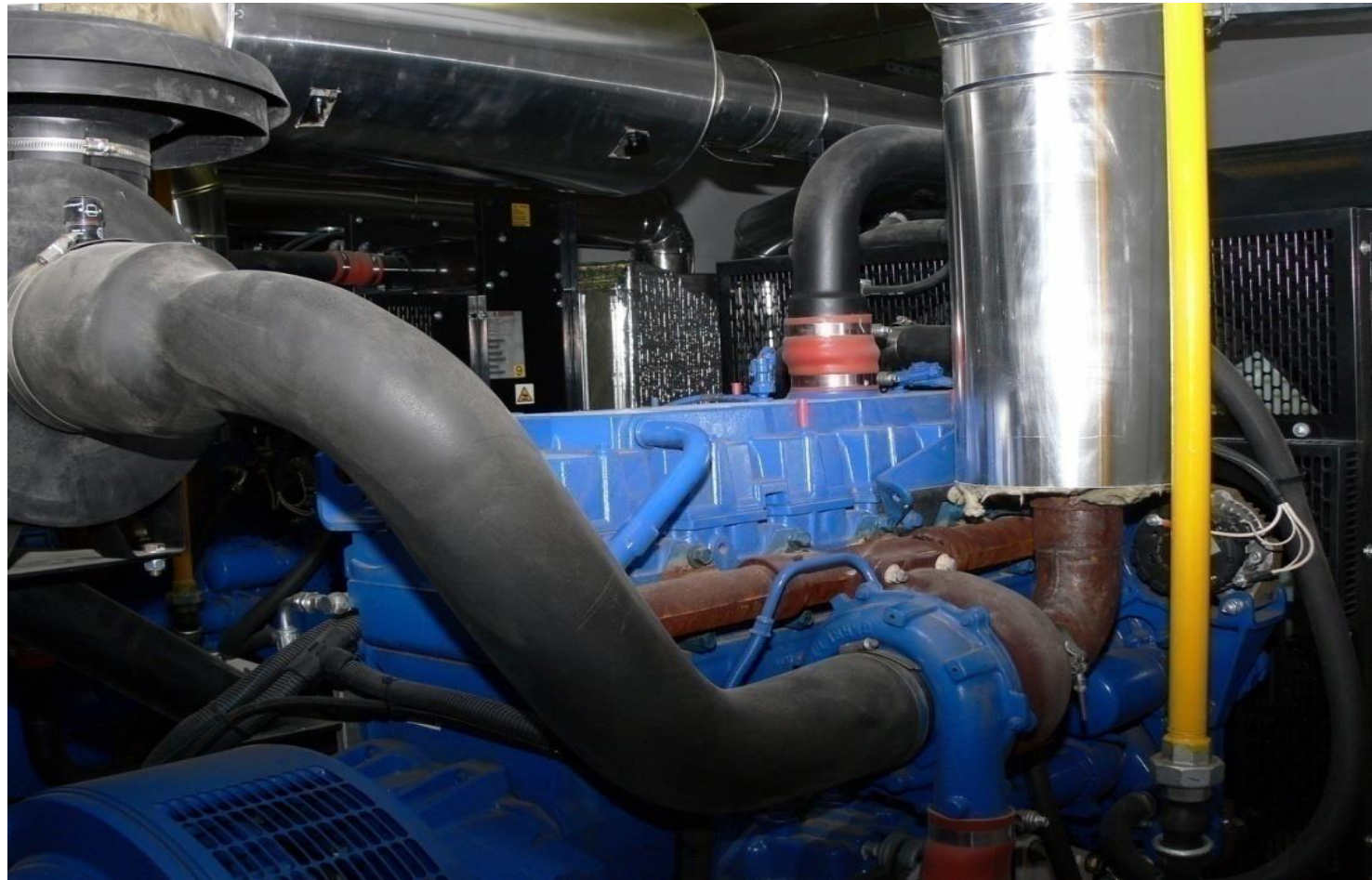
Резервный энергетический комплекс
